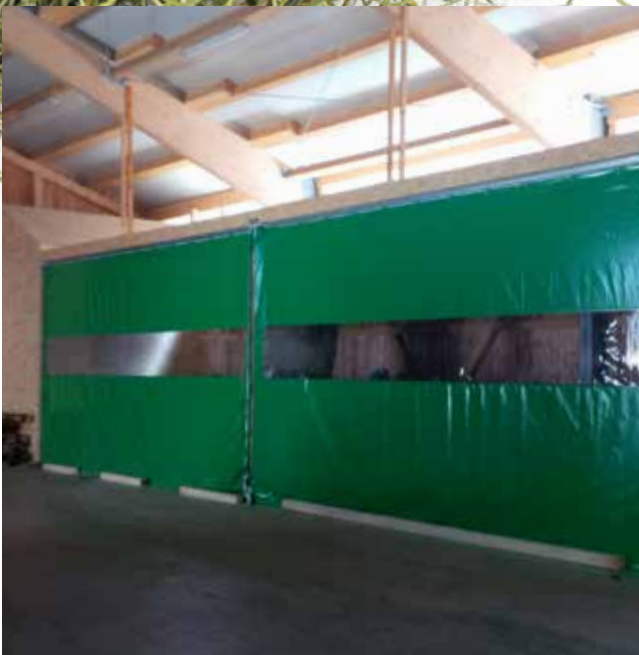
Rundballentrocknung mit Luftentfeuchter und Vorhang.
