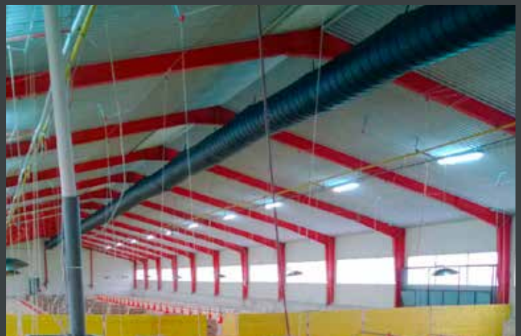
Hühner- und Putenstallheizung: Ein auf der Decke hängender Warmluftschlauch sorgt für eine gleichmäßige Wärmeverteilung.
